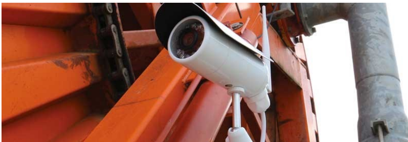
La caméra installée sur l'enrouleur d'irrigation
